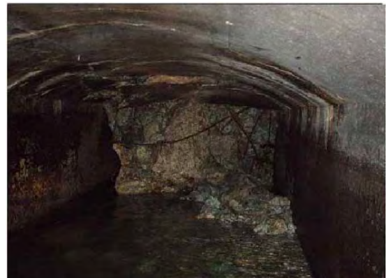
写真 2.2 崩落現場（矢野側）
