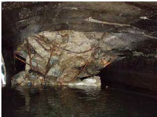
写真 2.1 崩落現場（西谷側）
